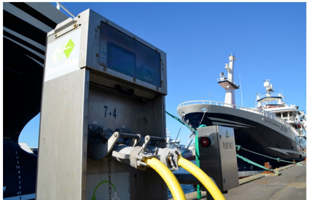
Foto: Landstrømsudtag på Coasterkajen (kaj 7)
